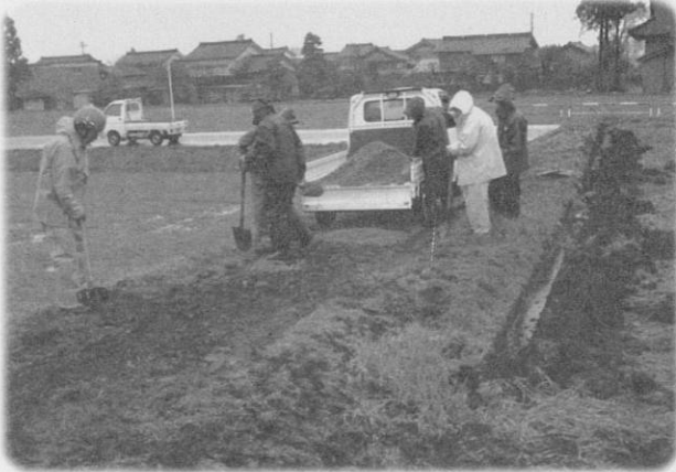
農道の補修整備 (朝日町 かなやま 「金山農地水環境保全委員会」)
